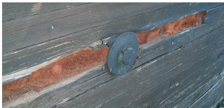
Esempi di carie soffice formatasi attorno al connettore di un ponte pedonale sul corso di un fiume
